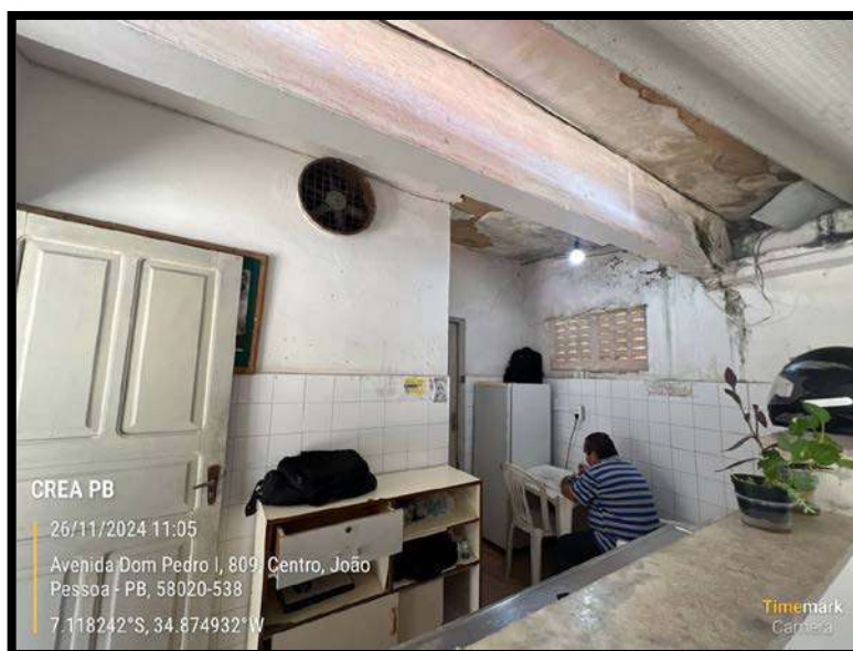
Figura 15 – Instalações precárias da área de vivência
