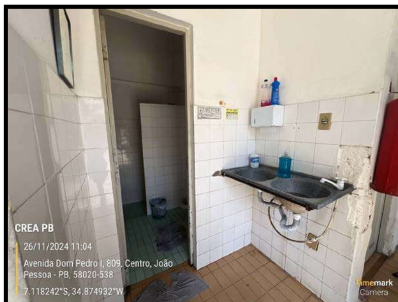
Figura 16 – Instalações precárias da área de vivência
