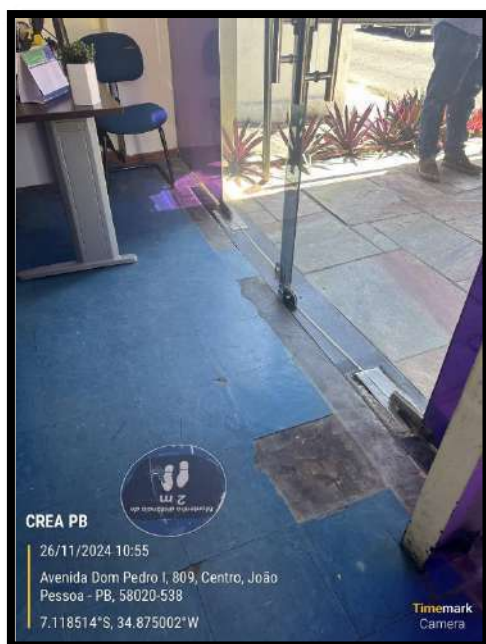
Figura 17– Piso vinílico deteriorado
