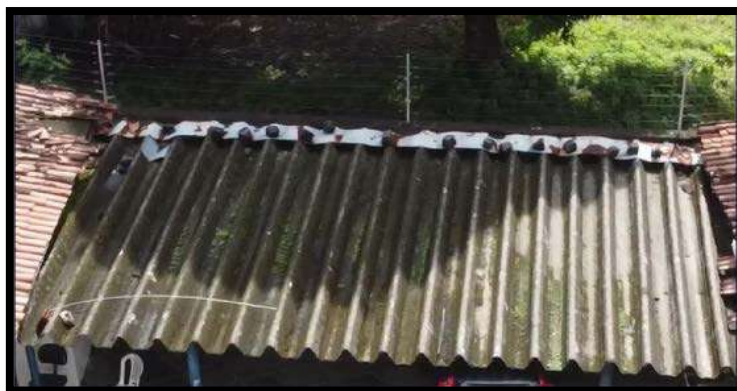
Figura 3 – Telhado Kalhetão totalmente deteriorado
