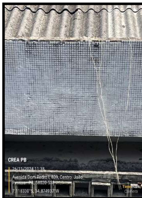
Figura 5 – Cabos expostos na fachada
