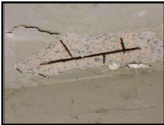
Figura 29– Ferragens expostas em estado de corrosão
