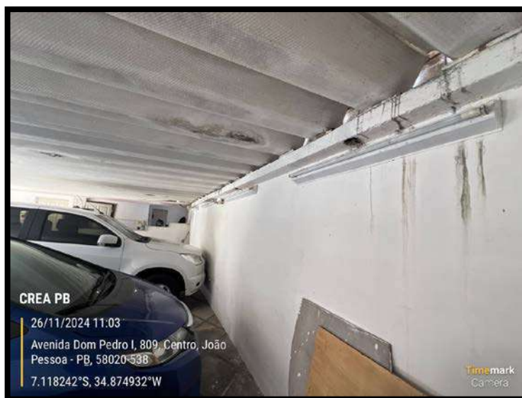
Figura 21 – Garagem com infiltrações
