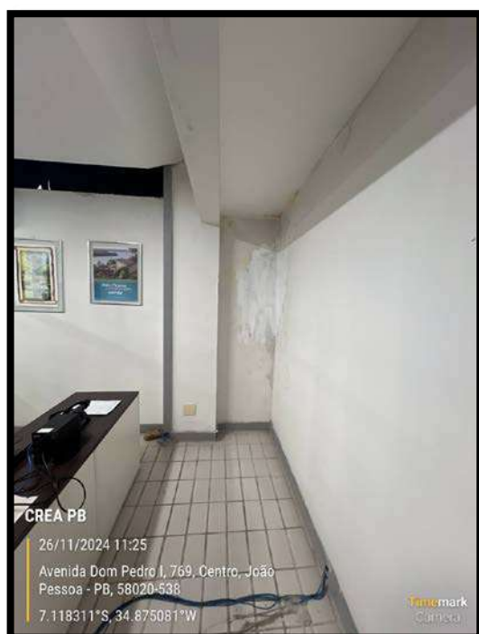
Figura 10 – Infiltrações nas paredes
