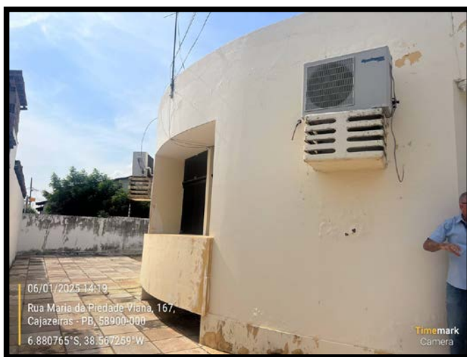
Figura 5 – Cabos expostos na fachada
